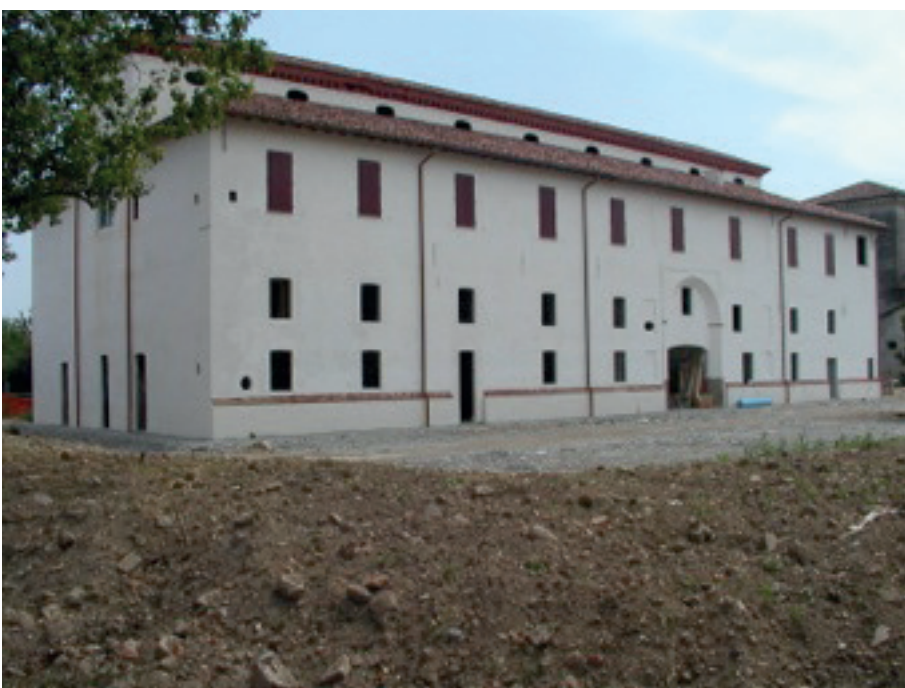
Il cantiere di restauro del Noviziato (ex Convento dei Gerolamini) a Ospedaletto Lodigiano (LO)
