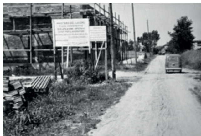
Un cantiere del "Piano di Occupazione Operaia Case per i Lavoratori" per il Ministero del Lavoro
