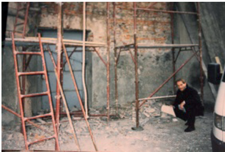
Il cantiere di restauro di Villa Torneamento a Monza e Francesco Sverzellati in sopralluogo al cantiere
